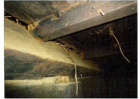
折損した鴨居
